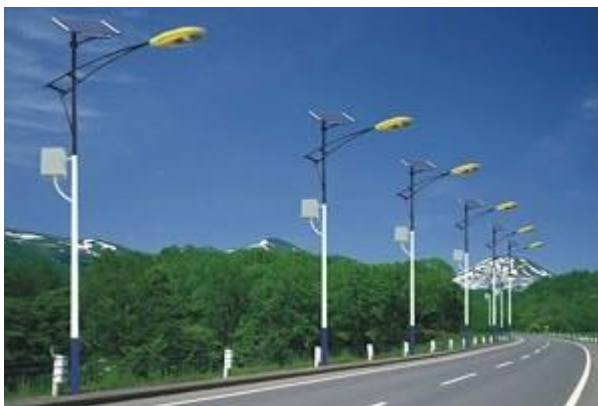
Рисунок 4–Светильники на солнечных батареях
